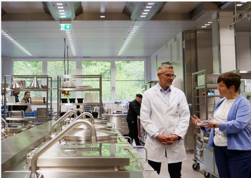
Das Herzstück – die Produktionsküche der Mensa, wo man auch aufgrund des klimafreundlichen Energiekonzepts weiterhin auf dampfbetriebene Kochkessel von MKN setzt. Jeder Arbeitsbereich ist klimatisiert dank moderner Lüftung von Halton.
